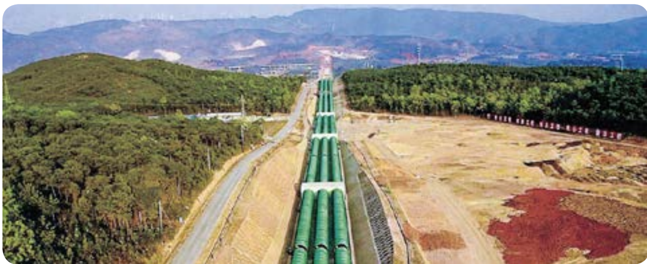
云南加快推进总投资1300亿元的滇中引水工程建设，图为滇中引水工程楚雄段观音山倒虹吸
