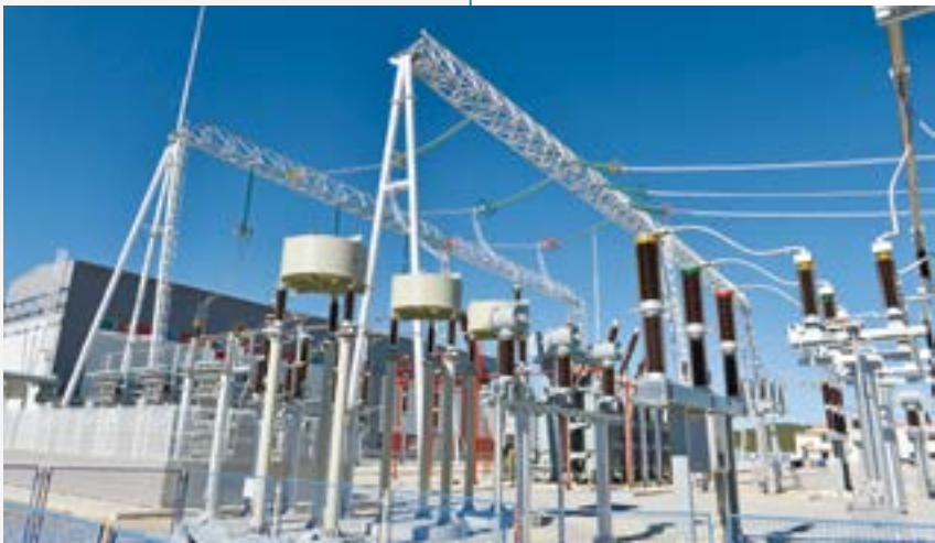
海拔3500米的500千伏建塘变电站 叶琳
