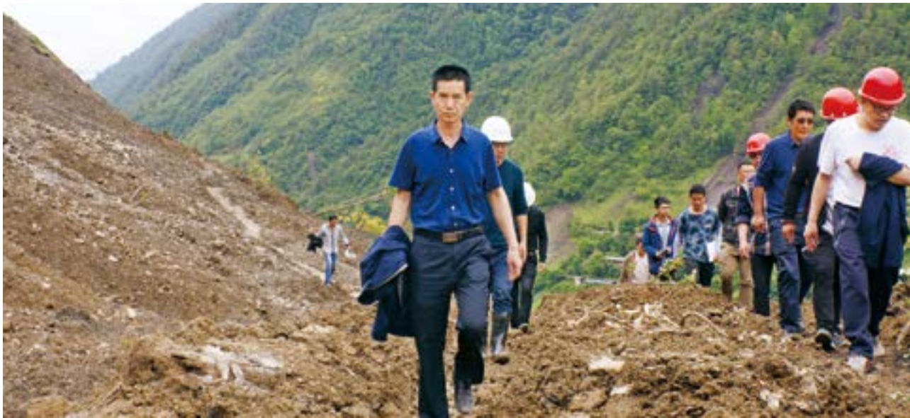
李忠海（前）和同事在德贡公路水毁塌方现场
