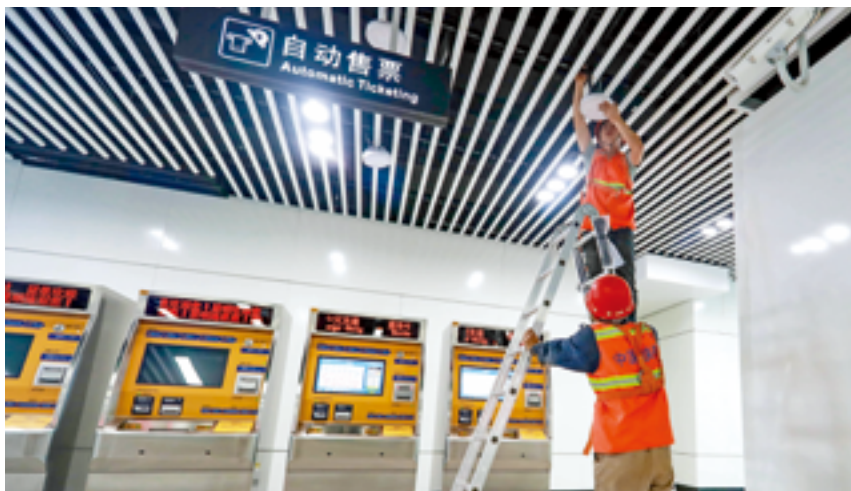
昆明市铁塔公司工作人员在地铁站安装5G天线 郝亚鑫
